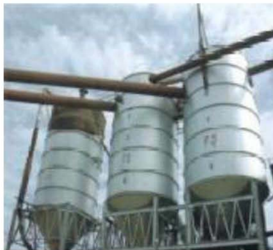
Εικόνα 4.13: Biomass Fuel SILO & Hopper
