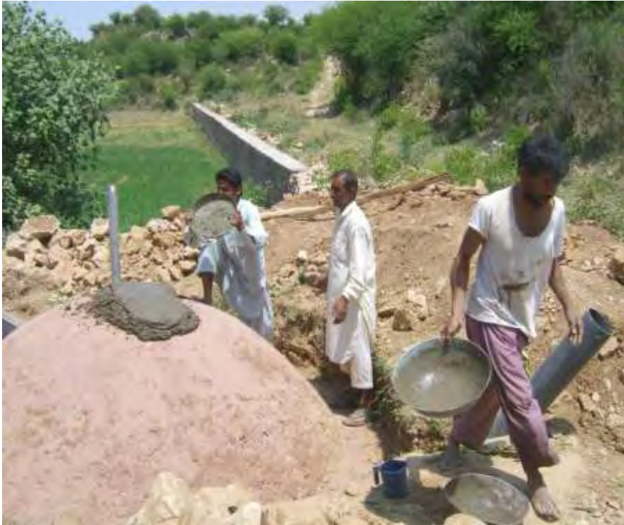
Εικόνα 4.1: Εγκατάσταση βιοαερίου οικογενειακής κλίμακας στο Πακιστάν ( www.bio-gas-plant.blogspot.com )
