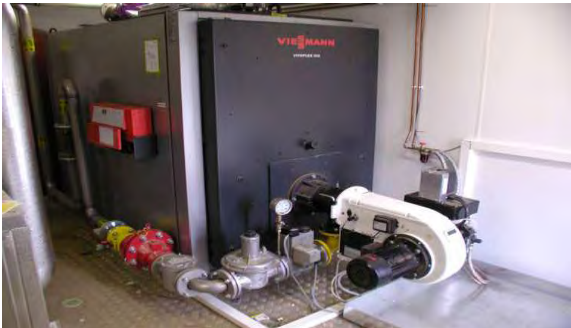
Εικόνα 3.1: Καυστήρας βιοαερίου για την παραγωγή θερμότητας ( www.biogas-plant.com )
