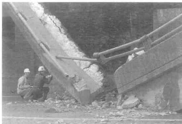
Εικόνα 10 Η διάβρωση "χτύπησε" αυτή τη γέφυρα στις Η.Π.Α [20]
