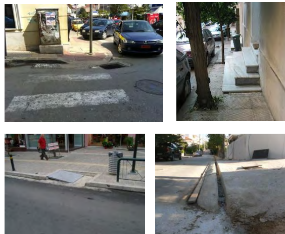
Εικόνα 6: Κακοτεχνίες και ανύπαρκτες ράμπες
