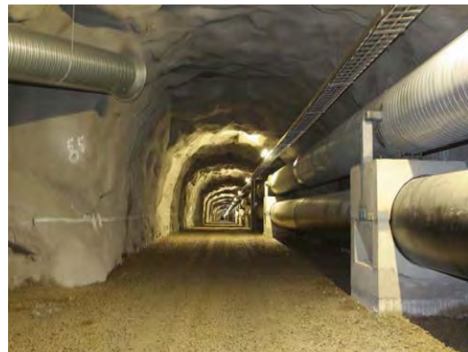
Εικόνα 24: Άποψη από το εσωτερικό των δικτύων κοινής ωφέλειας στο Ελσίνκι (Διαδίκτυο: City of Helsinki, 2009)
