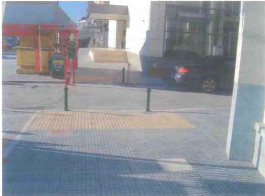
Φωτογραφία 5.2.5: Σκάφη σε πεζοδρόμιο (Πηγή: Ιδία επεξεργασία).
