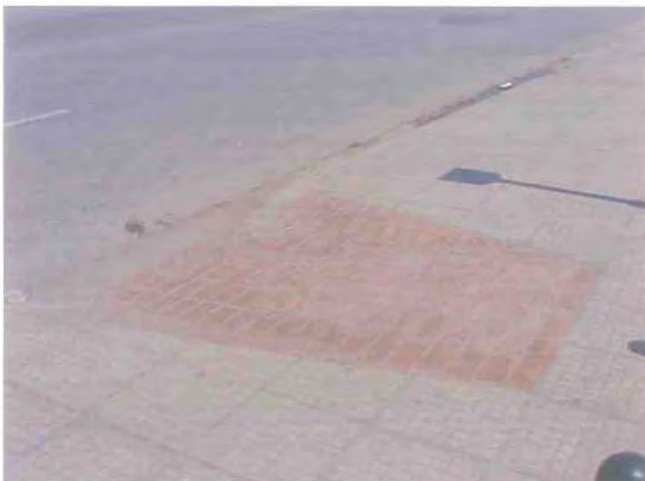
Φωτογραφία 5.2.7: Σκάφη σε πεζοδρόμιο (Πηγή: Ιδία επεξεργασία).
