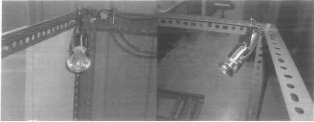
45) Δίκτυο φωτισμού της διάταξης
