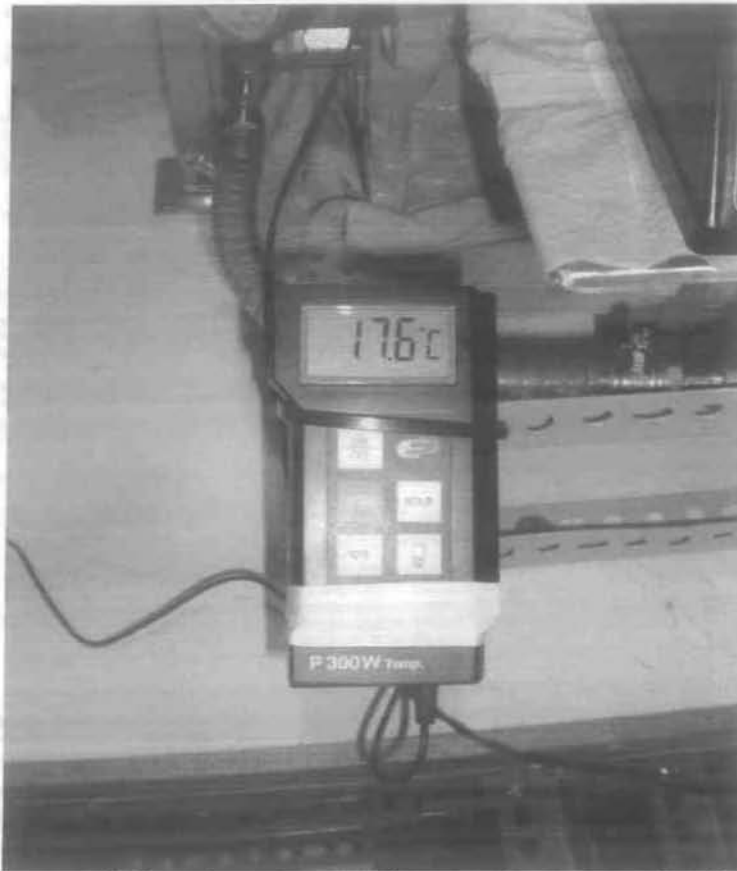
24) Ηλεκτρονικό θερμόμετρο για μέτρηση θερμοκρασίας λιπαντικού στην δεξαμενή αποθήκευσης
