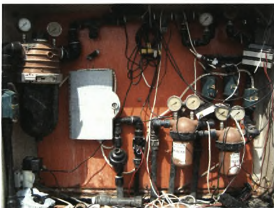
Εικόνα 7.6 Μηχανολογικός εξοπλισμός φυλασσόμενος σε ειδικά διαμορφωμένο κουτί.
