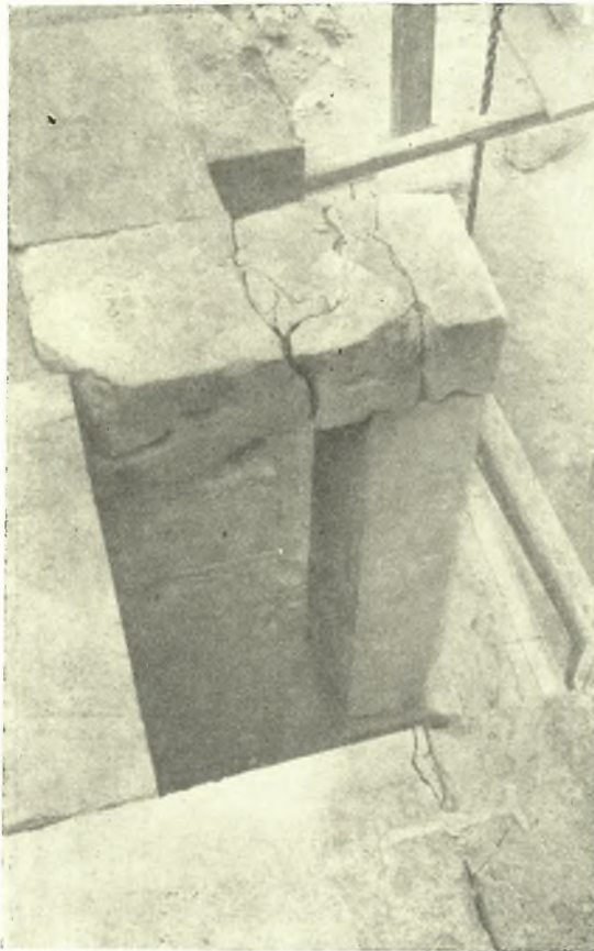
Εἰκ. 19. Τὸ ἐπίκρανον κατεστραμμένον τοῦ διαμέσου κιονίσκου. Οὗτος δὲν ἐφάπτεται τοῦ ὀπισθεν τοίχου.
