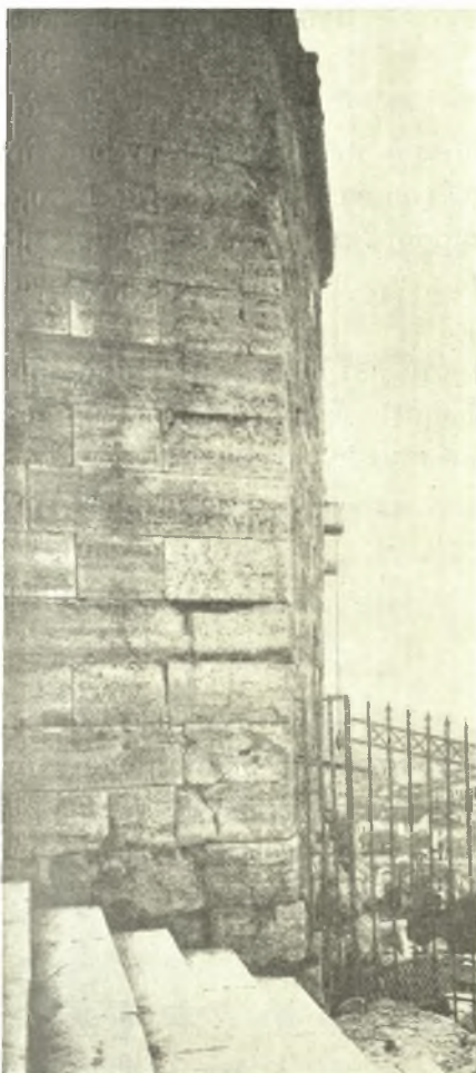
Εἰκ. 2. Ἐξόγκωσις τοῦ τοίχου κατὰ 0,10 τοῦ πρὸς δυσμὰς περιβλήματος.
