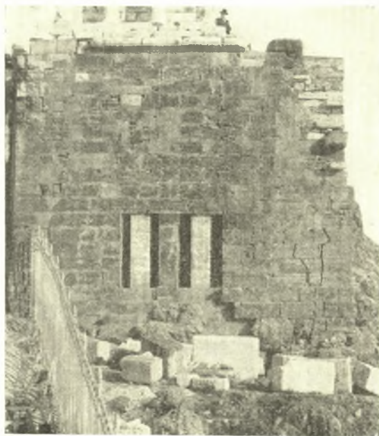
Εἰκ. 3. Ἡ πρὸς δυσμὰς ὄψις τοῦ πύργου τοῦ ναοῦ ἐν ᾗ ἐμφαίνονται τὰ κάθετα ῥήγματα τοῦ περιβλήματος.
