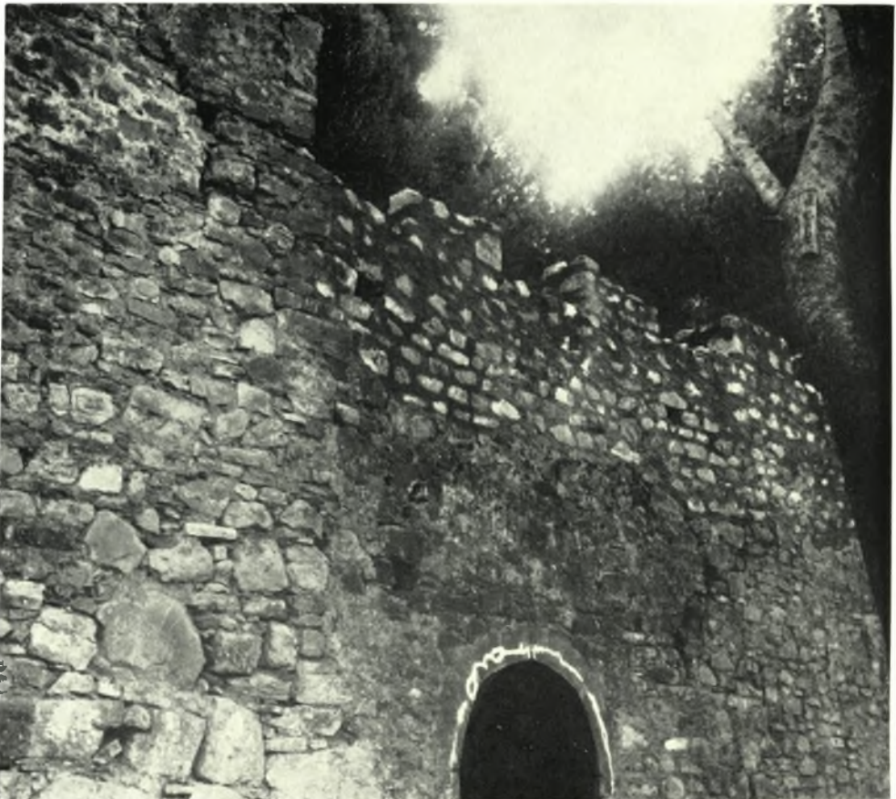
Αίτωλοακαρνανία. Ναύπακτος: α. Ἡ δυτική πλευρά τοῦ κρημισθέντος τείχους, ὕψους 11 μ., β. Ἀποκόλλησις τοῦ τείχους τοῦ δευτέρου διαζώματος, γ. Ἡ πύλη παρά τὸ ἐπισκευασθὲν τείχος μετὰ τὰς ἐργασίας
