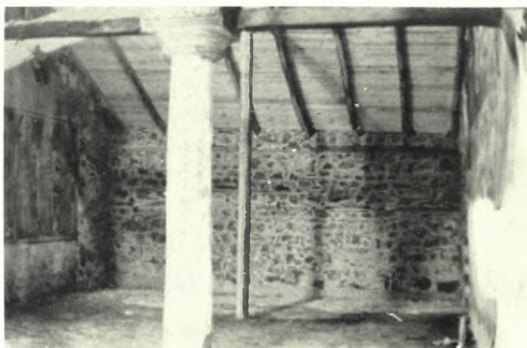
Μακεδονία. Βέροια: α. 'Ο ναός 'Αγίου 'Ιωάννου Θεολόγου μετά τās έργασίας ἀποκαταστάσεως, β - γ. 'Ο νότιος ἐξωτερικός τοίχος του 'Αγ. Γεωργίου πρό και μετά τήν ἀποκατάστασιν
