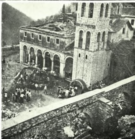
Ἰ. Μονὴ Εἰκοσιφοινίσσης Παργαίου: α. Γενικὴ ἄποψις, β. Παρεκκλήσιον Ἁγ. Βαρβάρας, γ. Τμήμα τῶν τόξων καὶ τοῦ ἀναλημματικοῦ τοίχου πρὸ τῆς ἐπισκευῆς
