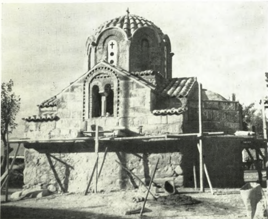
β. Ὁ ἐν Πλατανίτῃ τῆς Ἀργολίδος βυζαντινὸς ναὸς μετὰ τὰς ἀναστηλωτικὰς ἐργασίας. Ν. πλευρά.
