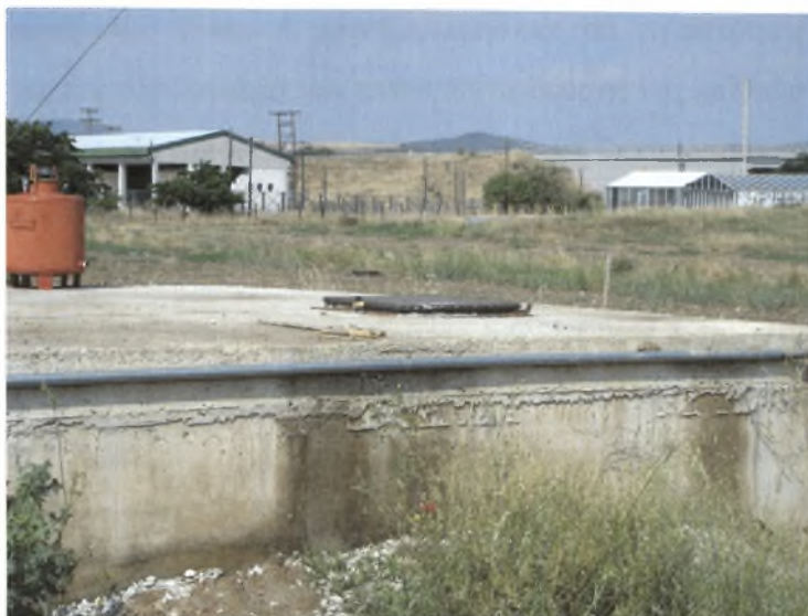
Εικόνα 3.8 Δεξαμενή συγκέντρωσης νερού άρδευσης
