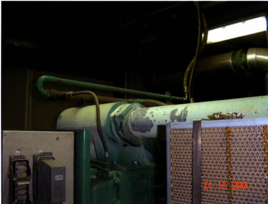
Φωτογραφία 3.7. : Η κατάληξη μιας εκ των τεσσάρων σωληνων στο after cooler.
