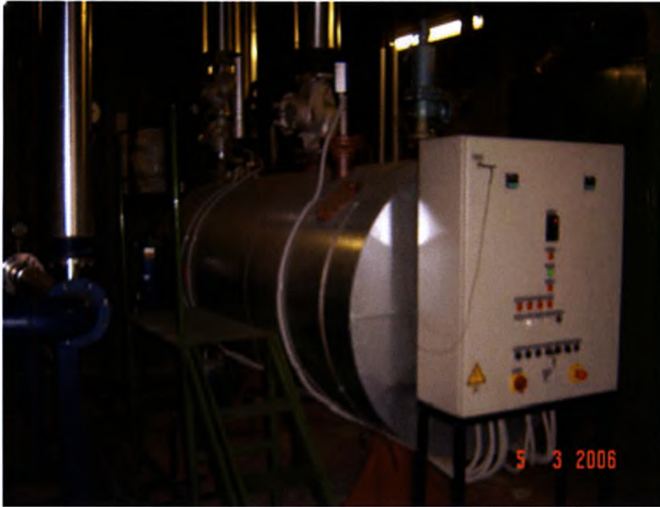
Φωτογραφία 5.3-Εναλλάκτης λαδιού-ατμού Εργοστασίου ΒΙΟΚΑΡΠΕΤ Α.Ε. με ονομαστικά μεγέθη: G=3.5\text{t/h} ατμοπαραγωγή και P_{\text{θερμική}}=1.8\text{MW} της γερμανικής εταιρείας Maxxtec όπου φαίνονται ο ηλεκτρικός πίνακας με τους αυτοματισμούς, η παροχή ατμού και οι σωλήνες προσαγωγής-επιστροφής λαδιού.
