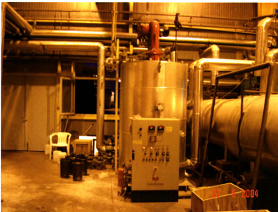
Φωτογραφία 1.2- Τμήμα του Σ.Η.Θ. όπου διακρίνεται ο λέβητας φ.α. GEKA KONUS και δεξιά της φωτογραφίας οι δύο εναλλάκτες καυσαερίων-λαδιου και καυσαερίων-νερού.
