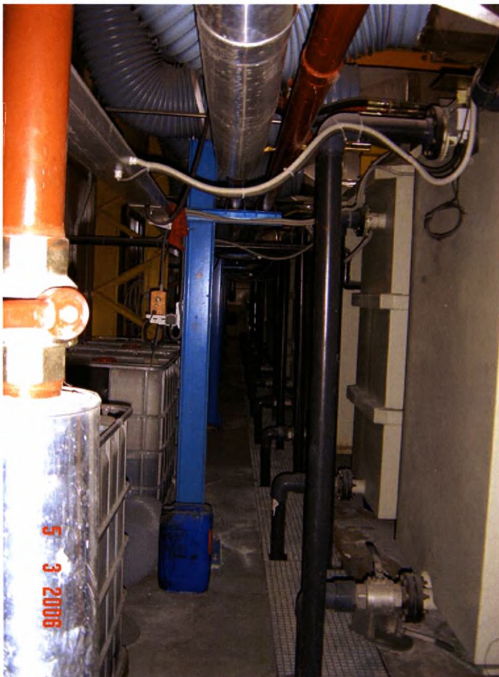
Φωτογραφία 5.7-Μπάνια νερού Οριζόντιας Ηλεκτροστατικής Βαφής συνολικής ισχύος 200.000kcal/h (232.4kW)
