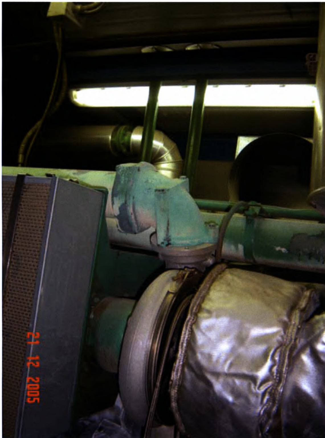
Φωτογραφία 3.6.: Στην αναρρόφηση του συμπιεστή καταλήγει το μίγμα αέρα-καυσίμου το οποίο στη συνέχεια όπως φαίνεται απο την κατάθλιψη κινείται προς το after cooler.
