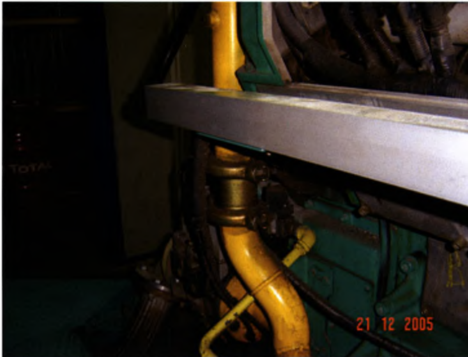
Φωτογραφία 3.2.-Συστημα εισαγωγής φυσικου αεριου προς καυση (κιτρινος σωληνας). Υπαρχουν δυο συστηματα εισαγωγής φυσικου αεριου στις δυο πλευρες της μηχανης οπως αυτο διακρίνεται καλύτερα στη φωτογραφία 2.2
