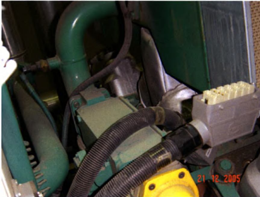
Φωτογραφία 3.3: Σύστημα μίξης αερα-καυσιμου (κουτι με δικτυωτο πλεγμα ενω φαινεται και ο κυλινδρος α8 απο τη μια πλευρα της μηχανης).συνολικα υπαρχουν 4 σταθμοι μογματος αερα-καυσιμου.
