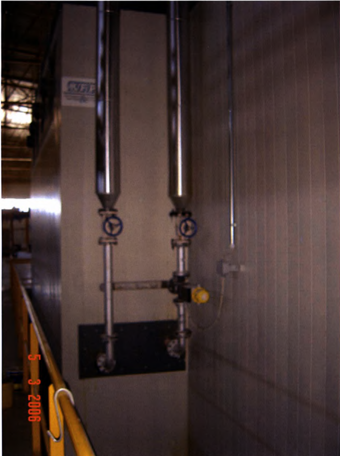
Φωτογραφία 5.2-Φούρνος λαδιού οριζόντιας ηλεκτροστατικής βαφής αλουμινίου ισχύος 450kW. Υπάρχει σε λειτουργία και φούρνος λαδιού κατακόρυφης ηλεκτροστατικής βαφής ισχύος 680kW.
