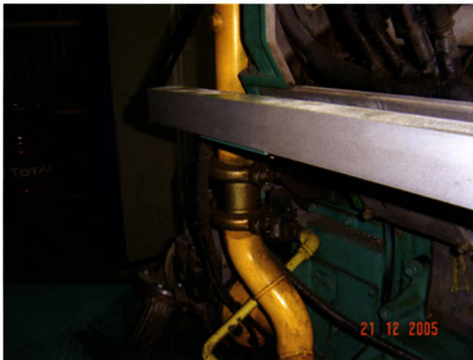
Φωτογραφία 3.2.-Συστημα εισαγωγής φυσικου αεριου προς καυση (κιτρινος σωληνας). Υπαρχουν δυο συστηματα εισαγωγής φυσικου αεριου στις δυο πλευρες της μηχανης οπως αυτο διακρίνεται καλυτερα στη φωτογραφια 2.2
