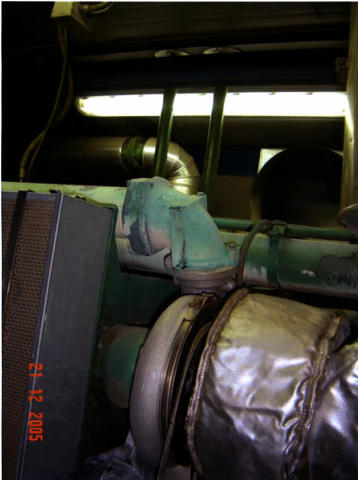
Φωτογραφία 3.6.: Στην αναρρόφηση του συμπιεστή καταλήγει το μίγμα αέρα-καυσίμου το οποίο στη συνέχεια όπως φαίνεται απο την κατάθλιψη κινείται προς το after cooler.
