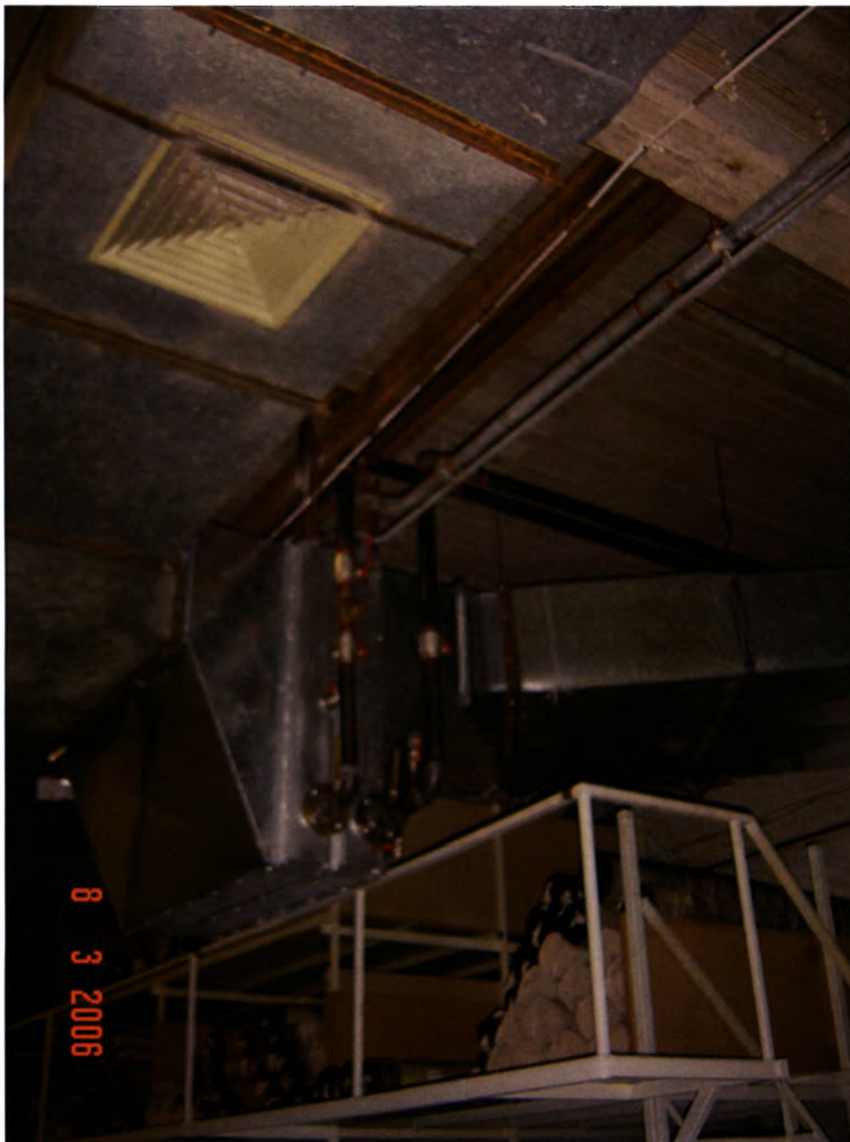
Φωτογραφία 5.5-Εναλλάκτης νερού-αέρα Τμήματος Αποθήκης Ταπήτων ονομαστικής ισχύος 250.000kcal/h ο οποίος αντικατάστησε αερολέβητα πετρελαίου ίδιας ισχύος. Τοποθετήθηκε στον αεραγωγό προσαγωγής και με την βοήθεια του ανεμιστήρα του αερολέβητας, καταθλίβεται ο ζεστός αέρας στον χώρο της Αποθήκης.
