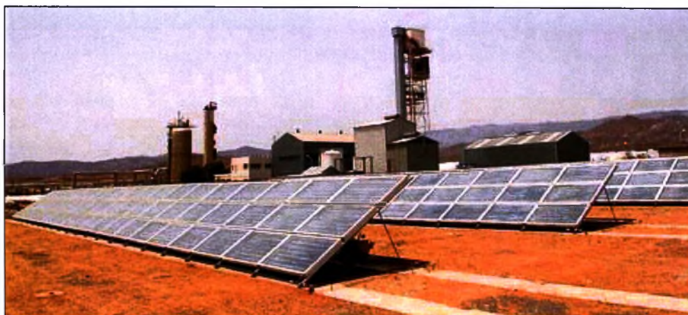
Εικόνα 2.4.3: Η εγκατάσταση με τους ηλιακούς συλλέκτες επιφάνειας 500 m 2 . [Πηγή: Blanco & Alarcon]
