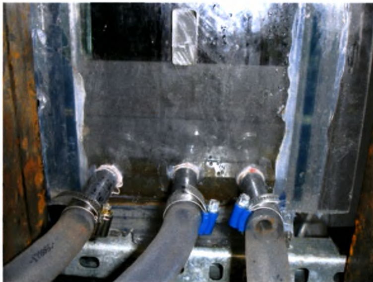
εικόνα 3.3. Δευτερεύουσα δεξαμενή και οι σωληνώσεις που επιτρέπουν την εισροή του υγρού (“μικρή” δεξαμενή)
