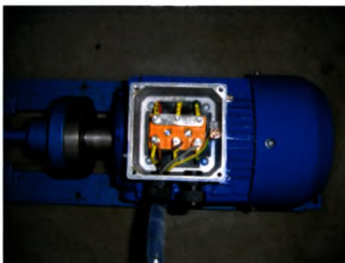
εικόνα 3.8. Συνδεσμολογία των φάσεων και της γείωσης του αναστροφέα με τον ηλεκτροκινητήρα της αντλίας.
