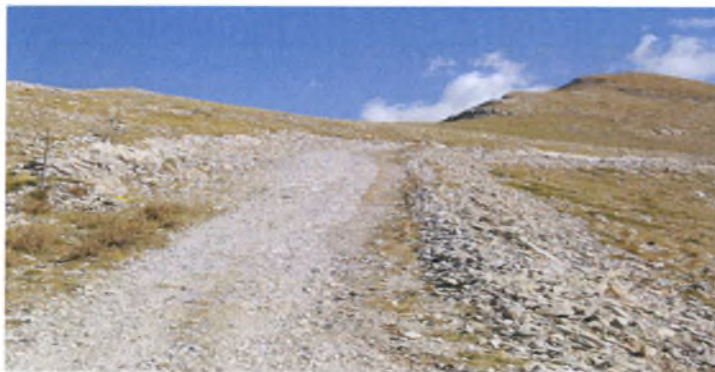
Φώτο 8: Κλίση του δρόμου στη θέση Σμέος
