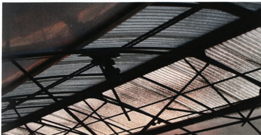
Μηχανισμός ανοιγμάτων οροφής
