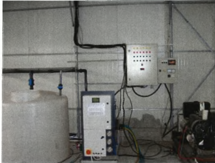
Σύστημα παρασκευής θρεπτικού διαλύματος (μονάδα άντλησης-δοσομέτρησης – αραιώσης πυκνών διαλυμάτων. (7)
