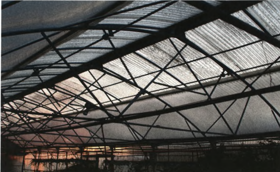
Σκελετός από αλουμίνιο στήριξης της οροφής πλαστικού θερμοκηπίου.
