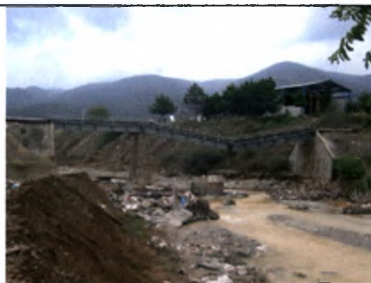
Εικόνα 35: Χείμαρρος Ξηριάς. Πλημμύρα Οκτωβρίου 2006. (Πηγή ΟΣΕ Βόλου).
