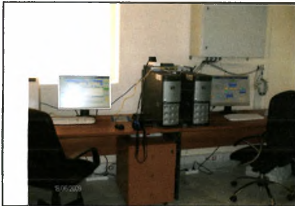
Εικόνα 18: Κέντρο ελέγχου αυτομάτου συστήματος δικτύου ύδρευσης ΔΕΥΑΜΒ. (Πηγή ΔΕΥΑΜΒ)
