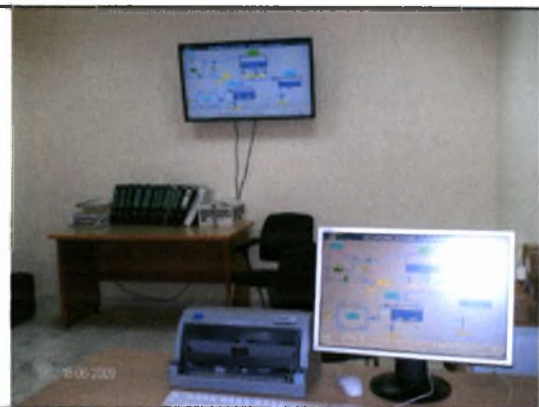
Εικόνα 19: Κέντρο ελέγχου αυτομάτου συστήματος δικτύου ύδρευσης ΔΕΥΑΜΒ. (Πηγή ΔΕΥΑΜΒ)
