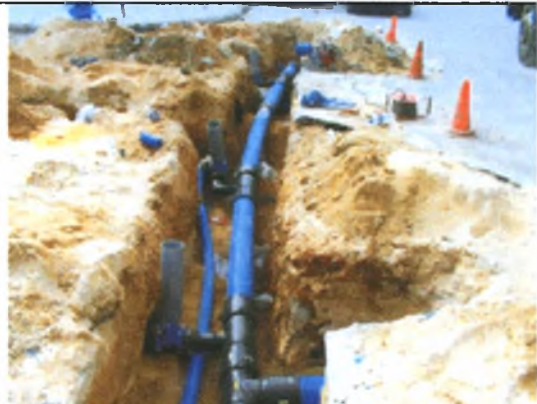
Εικόνα 15: Νέο δίκτυο και κλάδοι παροχών ΔΕΥΑΜΒ. (Πηγή ΔΕΥΑΜΒ).
