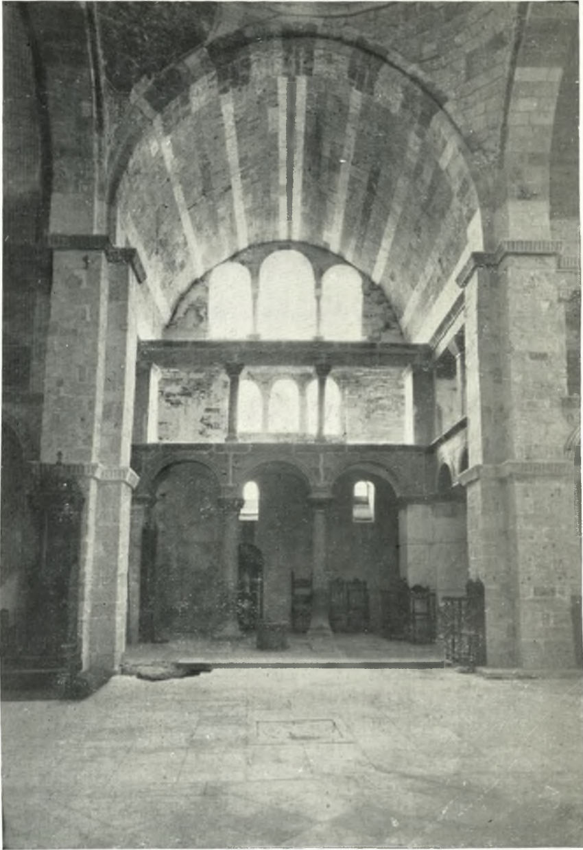
*Αποψις τοῦ ἐσωτερικοῦ τοῦ νοτίου σκέλους τοῦ σταυροῦ τῆς Καταπολιανῆς δεικνύουσα τὸ ἀνοιχθὲν μέγα τρίλοβον παράθυρον καὶ τὰς τριχρόμους σειρὰς θολιτῶν τῆς καμάρας.
