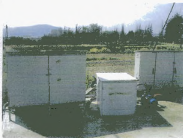
ΕΙΚΟΝΑ 4.7: Ο απαιτούμενος μηχανολογικός εξοπλισμός πάνω στη δεξαμενή νερού.
