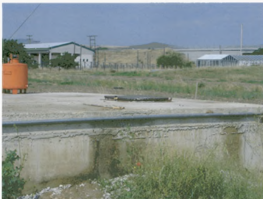
ΕΙΚΟΝΑ 3.1: Τσιμεντένια δεξαμενή συγκέντρωσης νερού.
