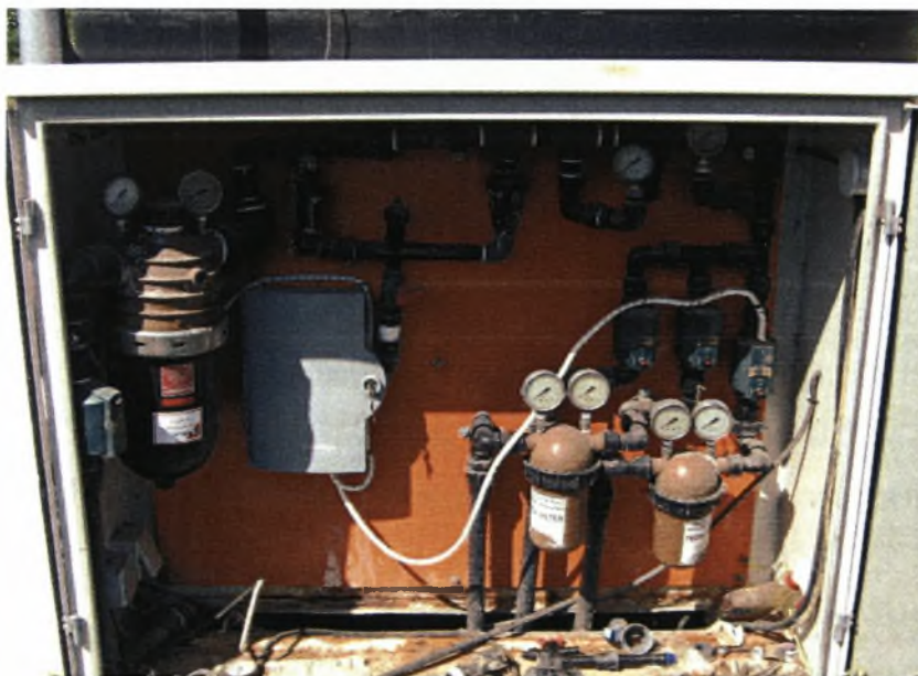
Εικόνα 4.2. Πίνακας ελέγχου του αρδευτικού συστήματος.
