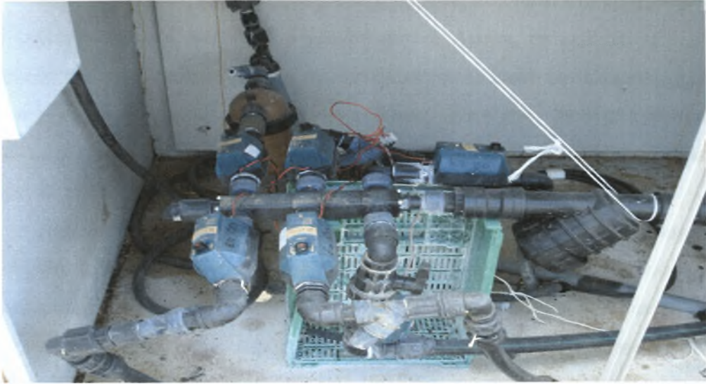
Εικόνα 5.6 Ηλεκτροβάνες συστήματος άρδευσης
