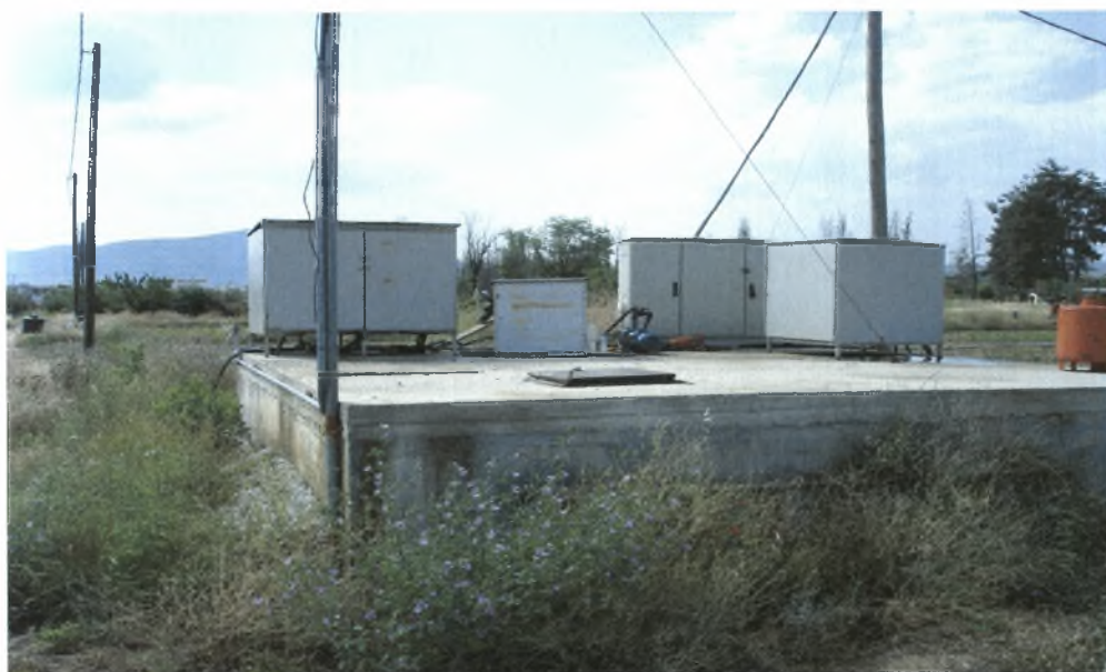
Εικόνα 5.4 Κυτία με μηχανολογικό εξοπλισμό άρδευσης
