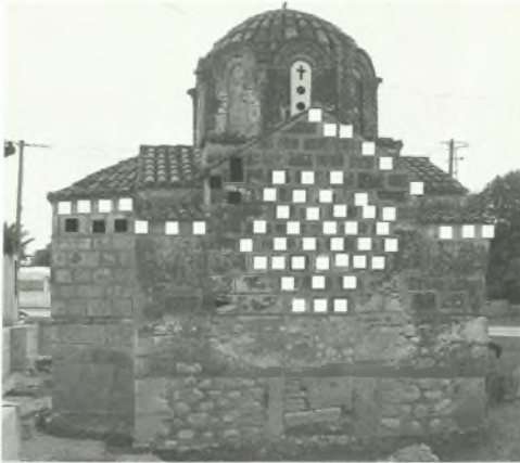
Εικ. 10. Η βόρεια όψη του μνημείου σήμερα. Με λευκό χρώμα σημειώνεται η προσθήκη νέου υλικού. Με σκούρο η αντικατάσταση φθαρμένου. Με το βέλος σημειώνεται η θέση του κεραμοπλαστικού
