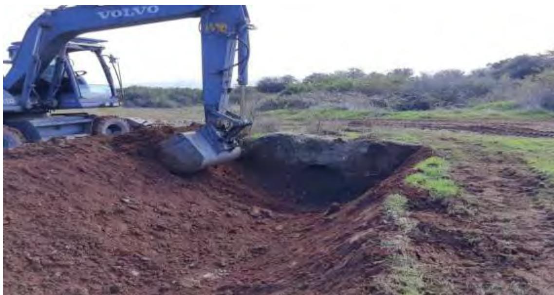
Εικόνα 91: Εκκαθάριση (ανεπαρκών)αποστραγγιστικών αγωγών από μεταφορά φερτών υλικών και υπερπλήρωση τους κατά τον Μεσογειακό κυκλώνα ΙΑΝΟΣ. (Αυλάκι Στυλίδας, Στερεά Ελλάδα) (Πηγή: Προσωπικό Αρχείο)
