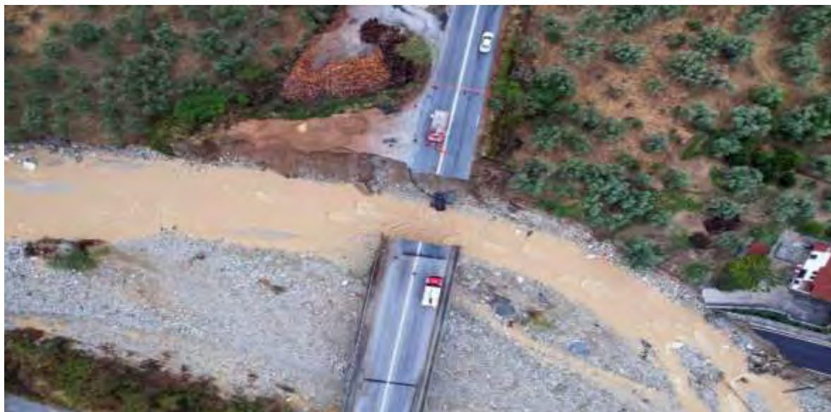
Εικόνα 80: Κατεστραμμένη γέφυρας στη λεκάνη απορροής Καλών Νερών της Επαρχιακής οδού Βόλου-Νεοχωρίου (Θεσσαλία) από υπερχειλίση χείμαρρου κατά την καταιγίδα NTANIEL.(Πηγή: https://www.lifo.gr/ )
