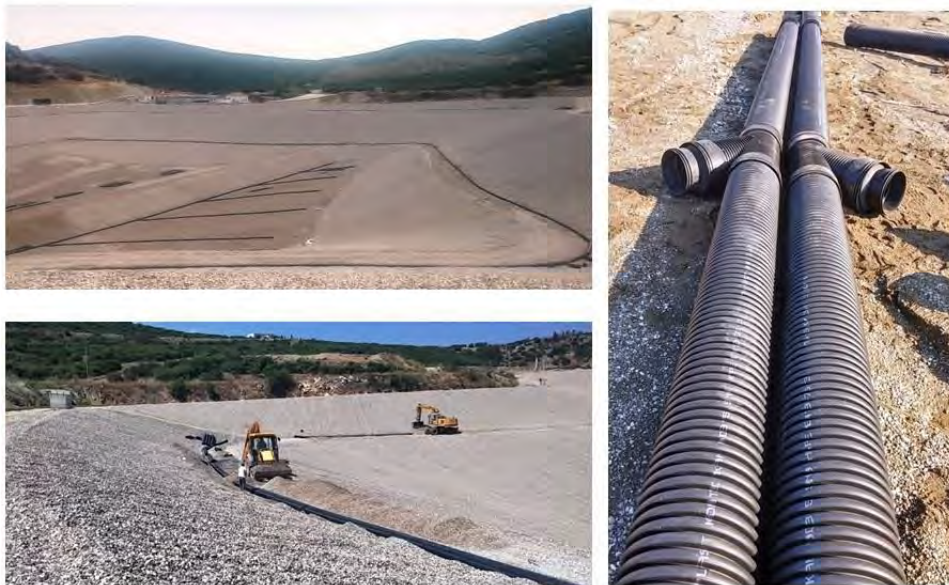
Εικόνα 36 Στρώση και αγωγοί αποστράγγισης.
