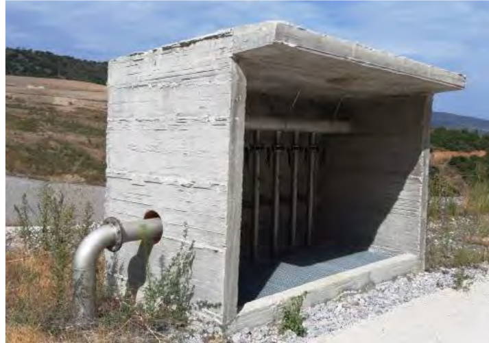
Εικόνα 26 Φρεάτιο συλλογής και έλεγχου βιοαερίου 23
