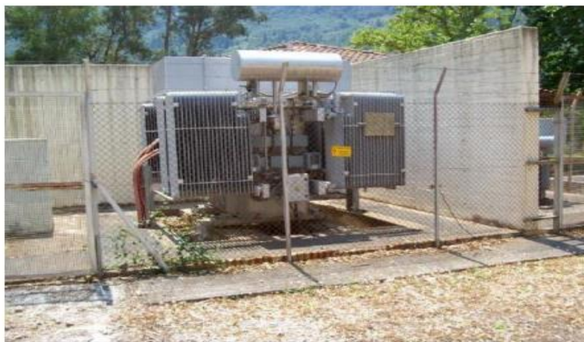
Εικόνα 4.5 Μετασχηματιστής ΥΗΣ Γλαύκου [17] ( Κεφάλαιο 1 (uniwa.gr) ).
