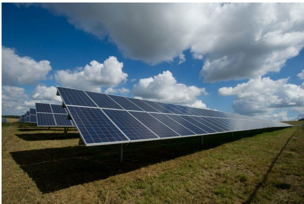
Εικόνα 6.2: Φωτοβολταϊκά πλαίσια με σταθερή βάση στήριξης
