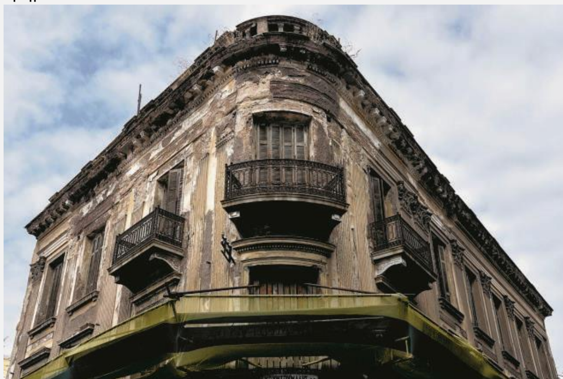
Εικόνα 10: Παραδείγματα εγκαταλελειμμένων κτηρίων στο κέντρο της Αθήνας 1/3
