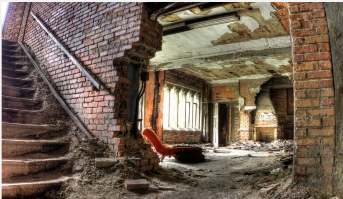
Εικόνα 6: Εγκαταλελειμμένο ακίνητο πηγή εγκλήματος
