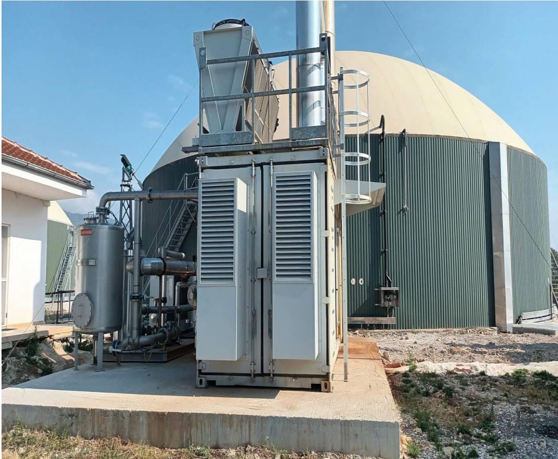
Εικόνα 18 Ο σταθμός παραγωγής ηλεκτρικής ενέργειας
