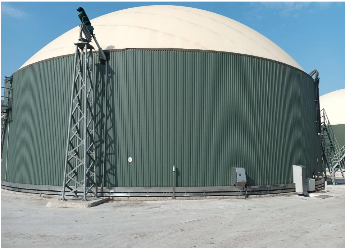
Εικόνα 15 Κινητός αναδευτήρας και εξωτερικά σημεία ελέγχου
