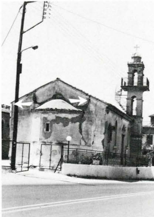
Εικόνα 19. Διαχωρισμός τοίχων από σεισμό σε εκκλησία της Καλαμάτας (1986). Διακρίνονται οι κάθετες ρωγμές στον τοίχο. Με τα βέλη υποδηλώνεται η διεύθυνση της σεισμικής δύναμης. (πηγή: Stiros-Jones 1996, 138, εκ.7a)
