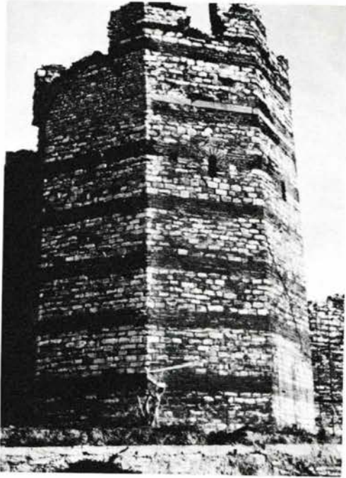
Εικόνα 24. Στρώσεις πλίνθων που παρεμβάλλονται ανάμεσα στους λίθους της τοιχοποιίας και ζώνουν περιμετρικά την κατασκευή στα πρώιμα βυζαντινά τείχη της Κωνσταντινούπολης (πηγή: Stiros-Jones 1996, 143, εικ.11)
