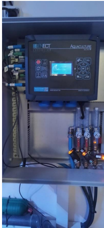
Εικόνα 4. Πίνακας ελέγχου συστήματος οξυγόνου
