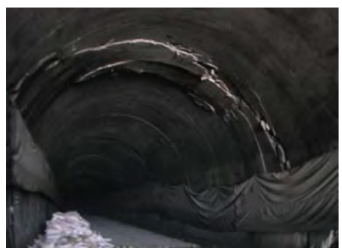
Εικόνα 2.8: Ακτινικές Ρωγμές κατά μήκος του δακτυλίου της στέψης στη σήραγγα Longxi μετά το σεισμό Wenchuan (Li, 2011)
