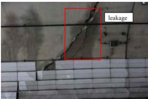
Εικόνα 2.5: Διαρροή υπόγειου νερού μέσω ρωγμών της επένδυσης μετά το σεισμό Kumamoto (Zhang et al., 2018)
