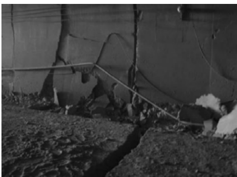
Εικόνα 2.7: Εγκάρσιες ρωγμές και μετατόπιση λόγω ρήγματος στη σήραγγα Longxi μετά το σεισμό Wenchuan (Li, 2011)
