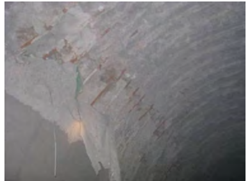
Εικόνα 2.6: Έκθεση του οπλισμού λόγω δόγκωσης και θραύσης της επένδυσης μετά το σεισμό Wenchuan (Li, 2011)
