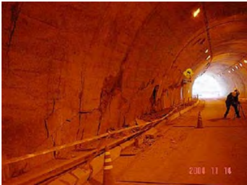
Εικόνα 2.3: Ρωγμές και αποφλοίωση της επένδυσης στη σήραγγα Kizawa μετά το σεισμό Mid-Niigata (Jiang et al., 2010)
