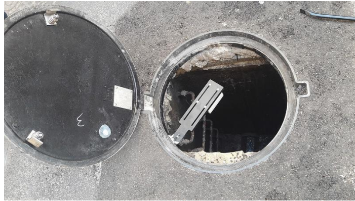
Εικόνα 62: Έξυπνο Σύστημα Παρακολούθησης και Ανίχνευσης Φραγής Φρεατίων
