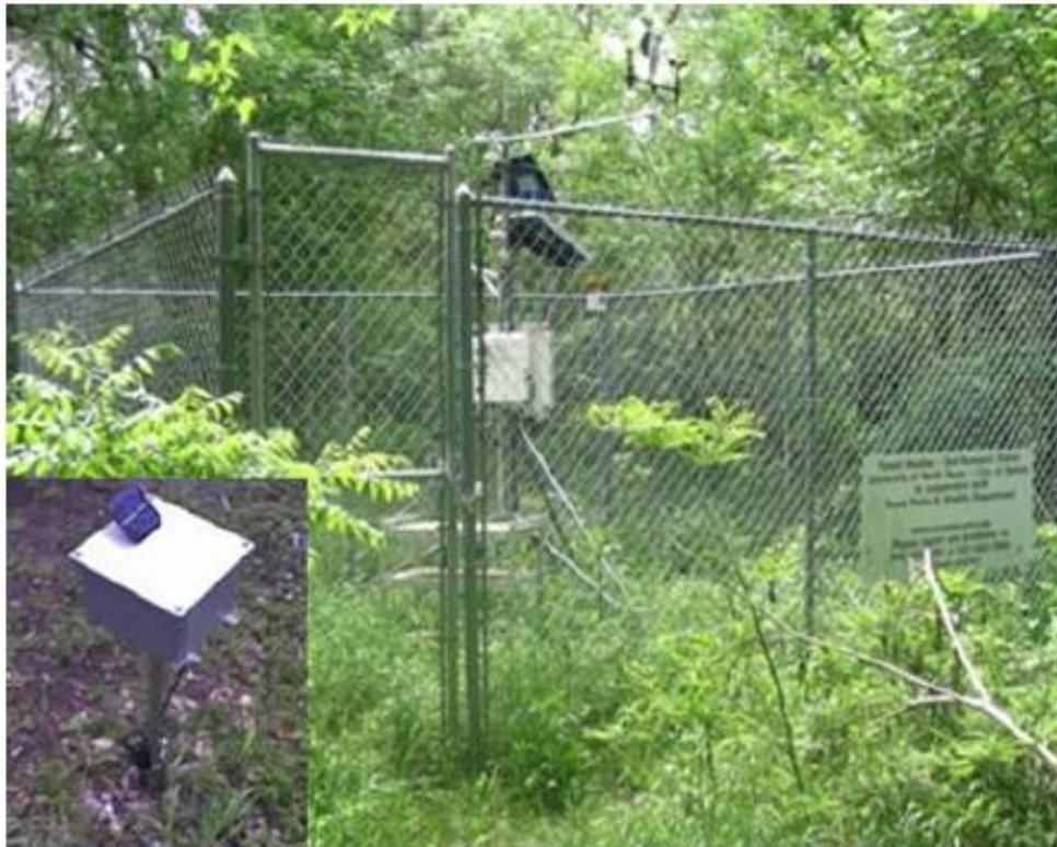
Σχήμα 9 Ο μετεωρολογικός σταθμός GBC και το ανθεκτικό στις καιρικές συνθήκες κουτί εγκατάστασης για μοτίβα [44]
