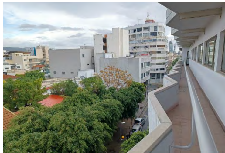
Εικόνα 89. Άποψη βόρειας πρόσοψης κτιρίου Λαϊκής και εφαρμογή κάθετου εφελκόμενου πλέγματος για ανάπτυξη βλάστησης στις πλευρικές προεξοχές του κτιρίου, Πηγή: Προσωπικό Αρχείο.
