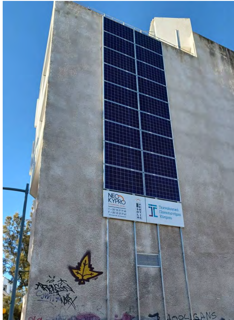
Εικόνα 79. Εφαρμογή κάθετων Φ/Β στο κτίριο Λαϊκής, Πηγή: Προσωπικό αρχείο.
