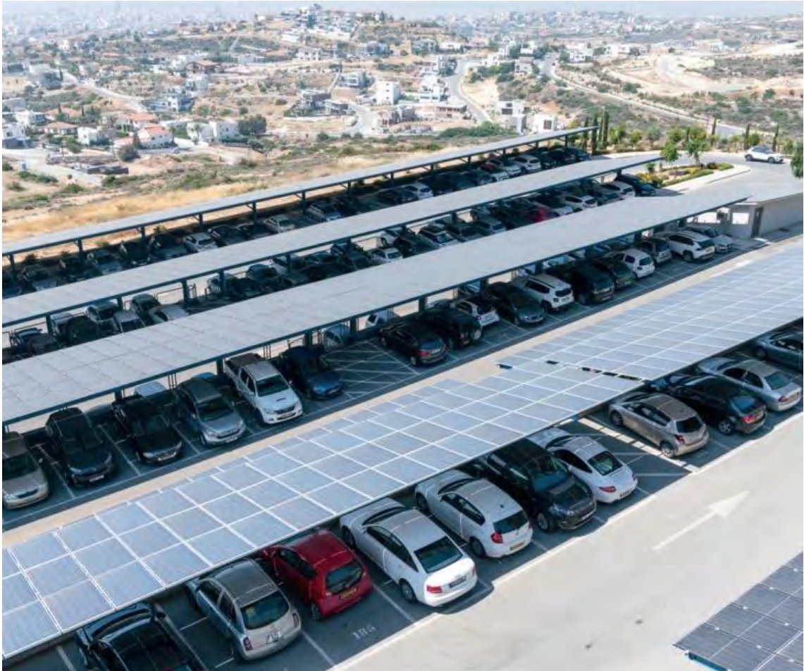
Εικόνα 80. Άποψη Φ/Β συστημάτων σε χώρους στάθμευσης του Γερμοανικού Ογκολογικού Κέντρου στην Λεμεσό, Πηγή: Filenews, 2022.
