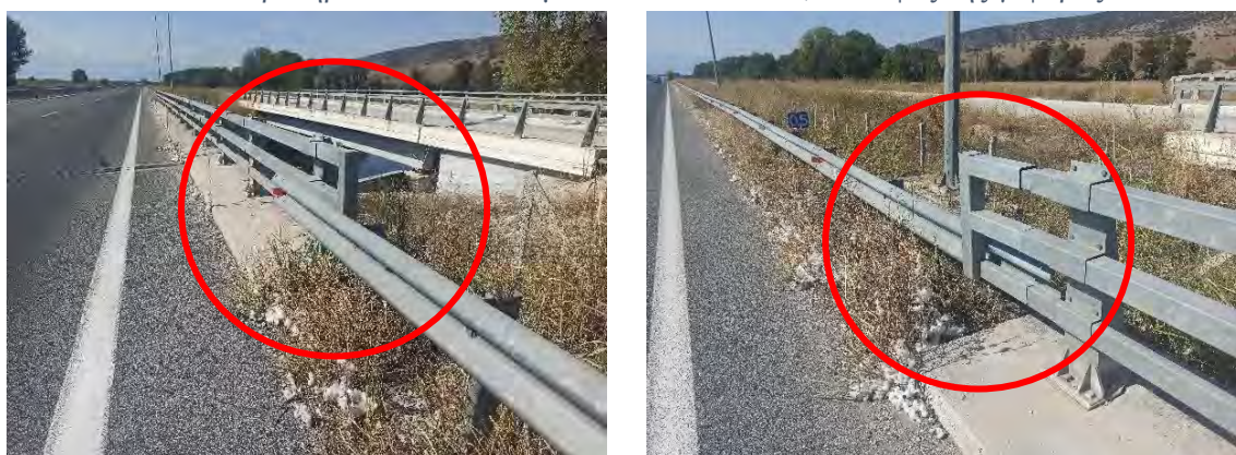
Χ.Θ. : 45+450 : Συναρμογές που δεν πληρούν τις προδιαγραφές & απαιτείται αποκατάσταση
