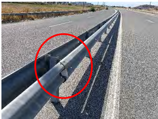
Χ.Θ. : 42+110 : Αντίθετη φορά λεπίδας & απαιτείται αποκατάσταση
