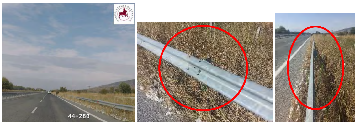
Χ.Θ. : 44+280 : Απαιτείται αφαίρεση παλαιών ορθοστατών & τοποθέτηση κοχλίων σύσφιξης
