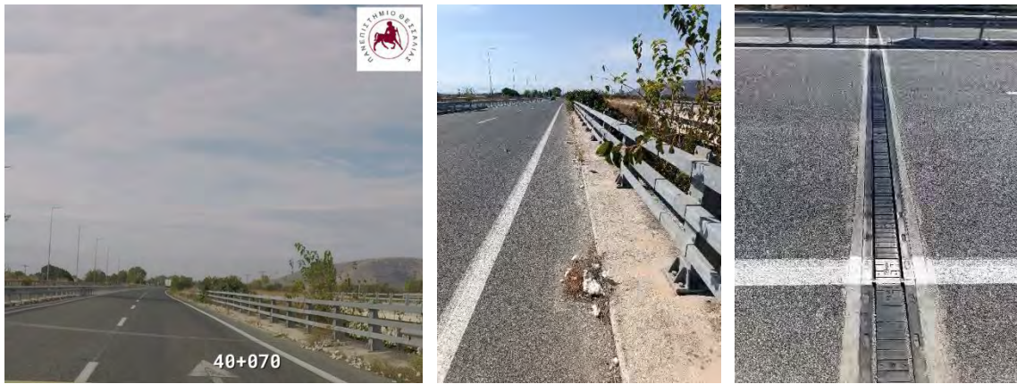
Εικόνες : Υφιστάμενη κατάσταση φρεατίων & αρμού επί γέφυρας (Χ.Θ. : 40+100), κατεύθυνση προς Τρίκαλα (Πηγή : Ιδία επεξεργασία)
