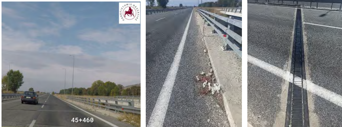
Εικόνες : Υφιστάμενη κατάσταση φρεατίων & αρμού επί γέφυρας (Χ.Θ. : 45+500), κατεύθυνση προς Τρίκαλα (Πηγή : Ιδία επεξεργασία)
