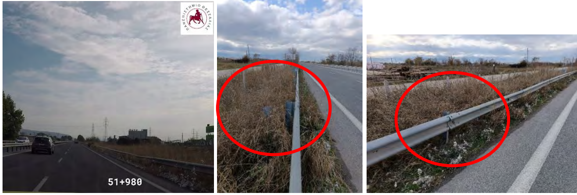
Χ.Θ. : 51+980 : Έλλειψη κοιλίων, απαιτείται αποκατάσταση & αφαίρεση παλαιών ορθοστατών
