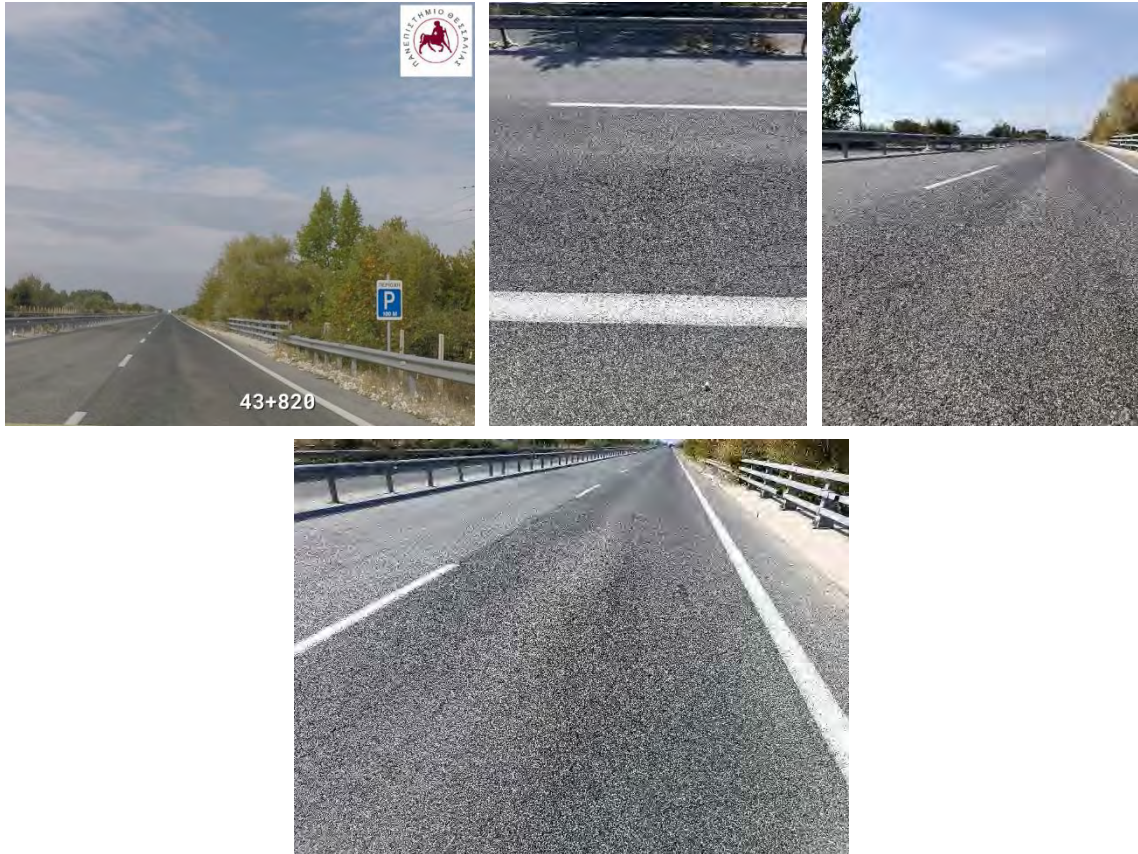
Εικόνες : Υφιστάμενη κατάσταση οδοστρώματος (Χ.Θ. : 43+820), κατεύθυνση προς Τρίκαλα (Πηγή : Ιδία επεξεργασία)
