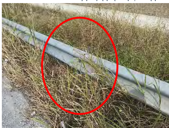
Χ.Θ. : 53+010 : Έλλειψη κοιλίων σύσφιξης & απαιτείται αποκατάσταση
