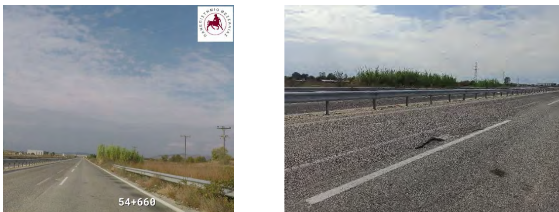
Εικόνες : Υφιστάμενη κατάσταση οδοστρώματος (Χ.Θ. : 54+660), κατεύθυνση προς Τρίκαλα (Πηγή : Ιδία επεξεργασία)
