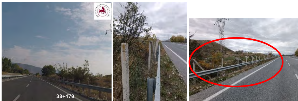
Χ.Θ. : 38+470 : Απαιτείται περαιτέρω ασφάλιση της οδού, λόγω πλευρικού εμποδίου
