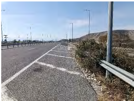
Χ.Θ. : 41+700 : Μη επαρκής απόσταση εμποδίου (ιστός οδοφωτισμού), απαιτείται μετατόπιση
