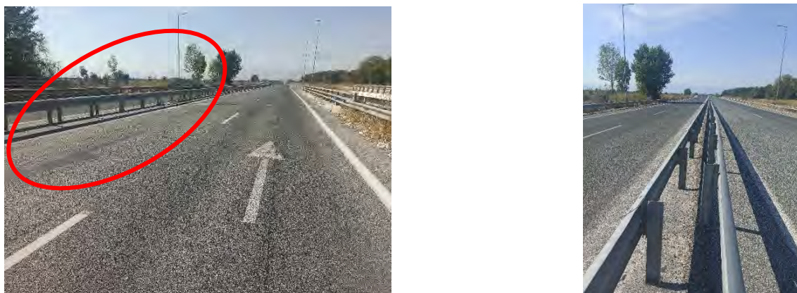
Χ.Θ. : 45+450 : Ακατάλληλος τύπος στηθαίου ασφαλείας & απαιτείται αποκατάσταση
