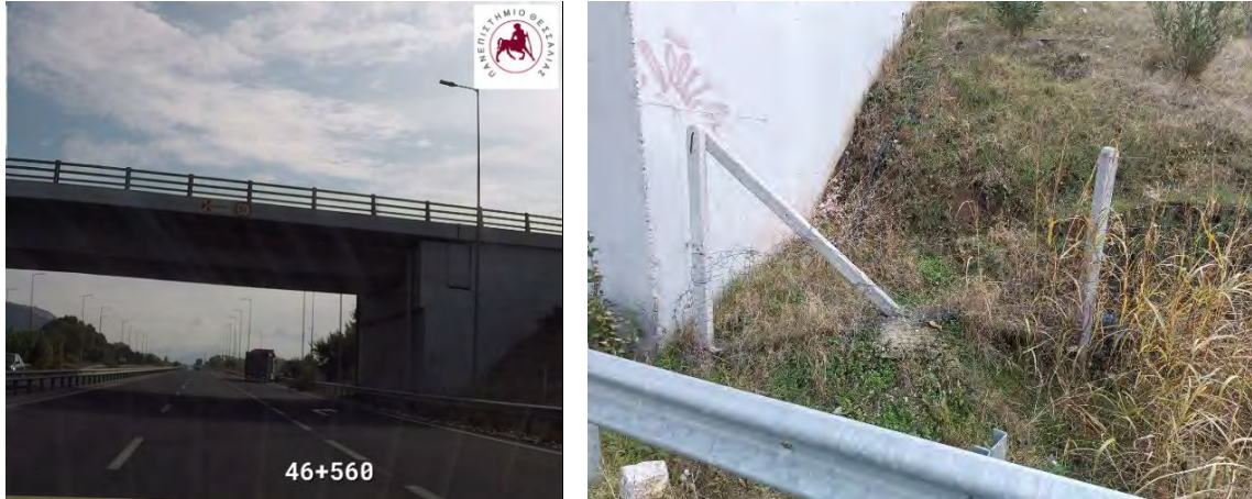
Εικόνες : Φθορά περίφραξης πλησίον τεχνικού άνω διάβασης, κατεύθυνση προς Λάρισα (Πηγή : Ιδία επεξεργασία)
