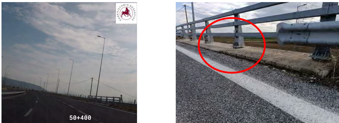
Χ.Θ. : 50+400 : Έκθεση αγκυριών έδρασης στηθαίου ασφαλείας & απαιτείται αποκατάσταση
