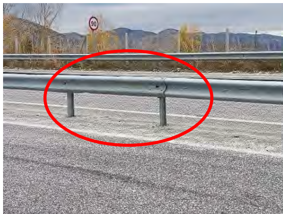
Χ.Θ. : 36+820 : Έλλειψη κοιλίων σύσφιξης & απαιτείται αποκατάσταση
