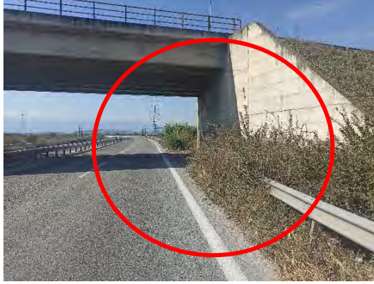
Χ.Θ. : 54+100 : Έλλειψη συνέχειας ασφάλισης & απαιτείται η τοποθέτηση στηθαίου ασφαλείας
