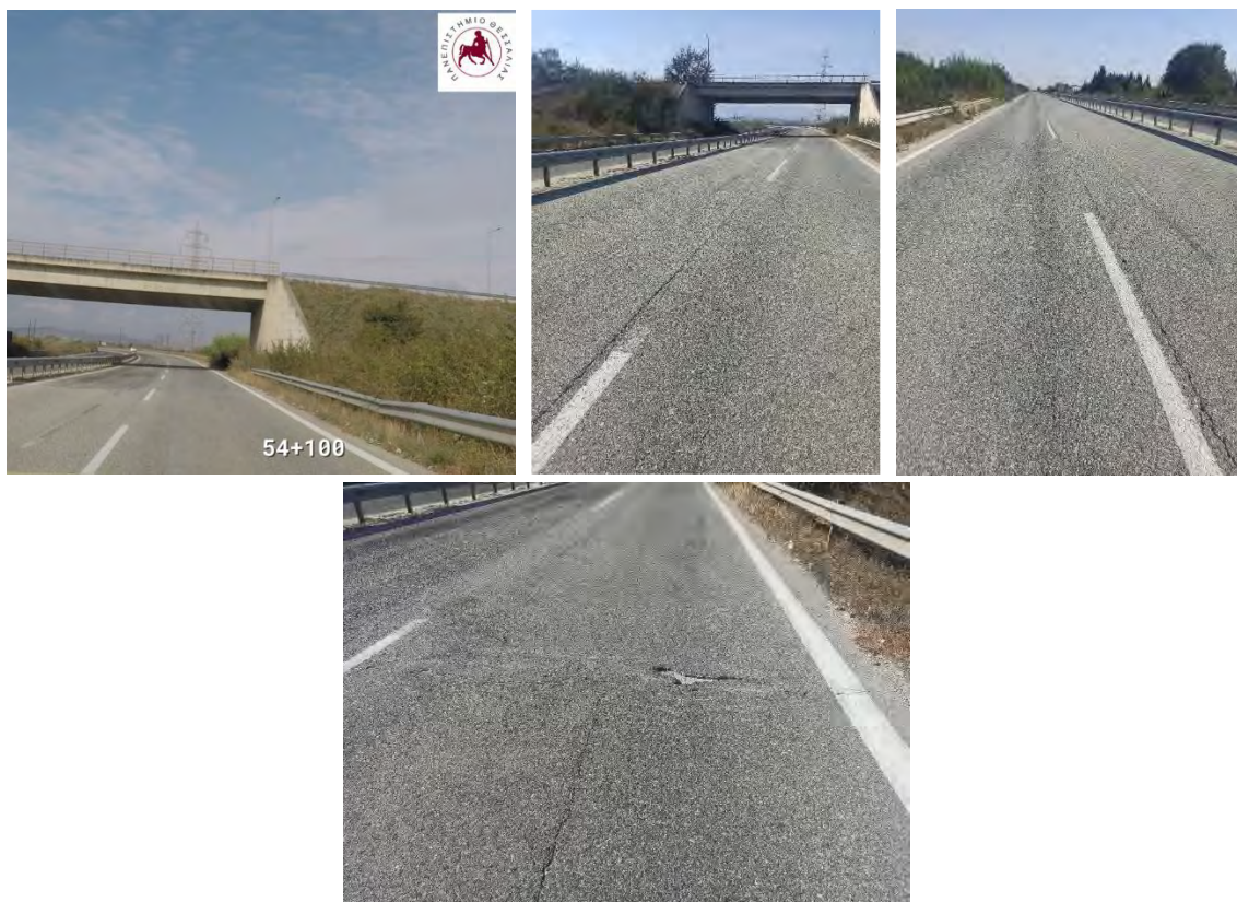
Εικόνες : Υφιστάμενη κατάσταση οδοστρώματος (Χ.Θ. : 54+100), κατεύθυνση προς Τρίκαλα (Πηγή : Ιδία επεξεργασία)
