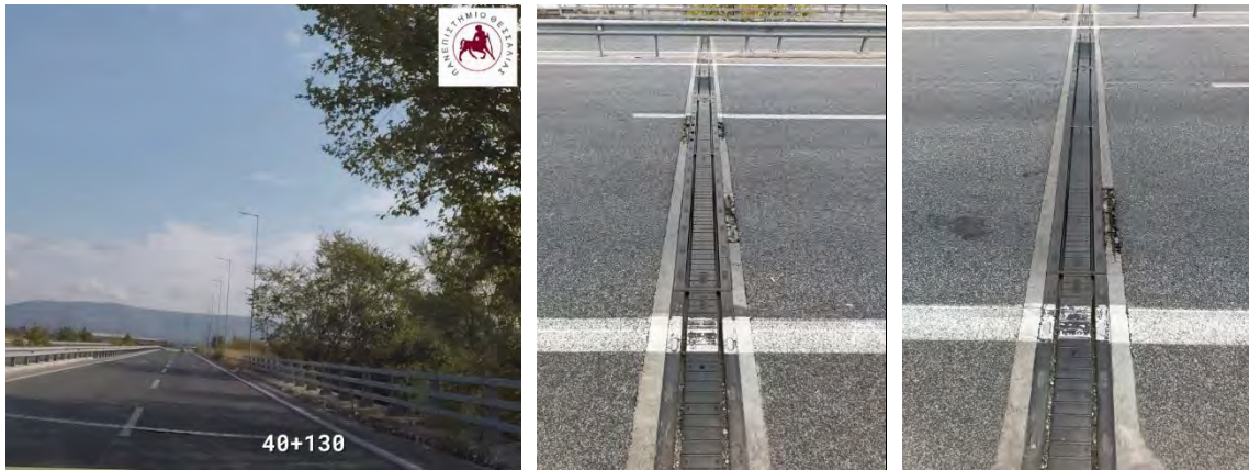
Εικόνες : Υφιστάμενη κατάσταση οδοστρώματος (Χ.Θ. : 40+130), κατεύθυνση προς Λάρισα (Πηγή : Ιδία επεξεργασία)
