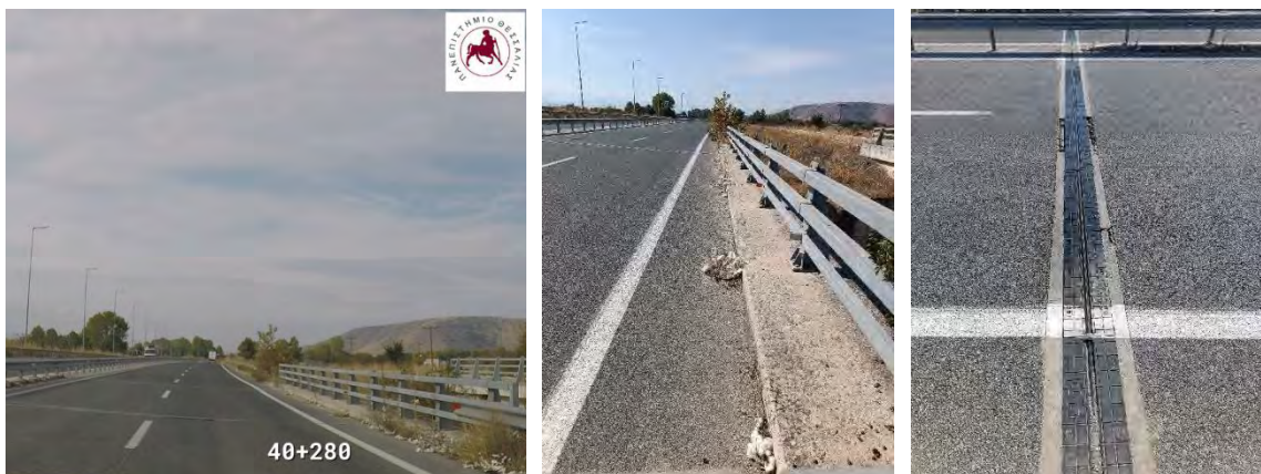
Εικόνες : Υφιστάμενη κατάσταση φρεατίων & αρμού επί γέφυρας (Χ.Θ. : 40+300), κατεύθυνση προς Τρίκαλα (Πηγή : Ιδία επεξεργασία)
