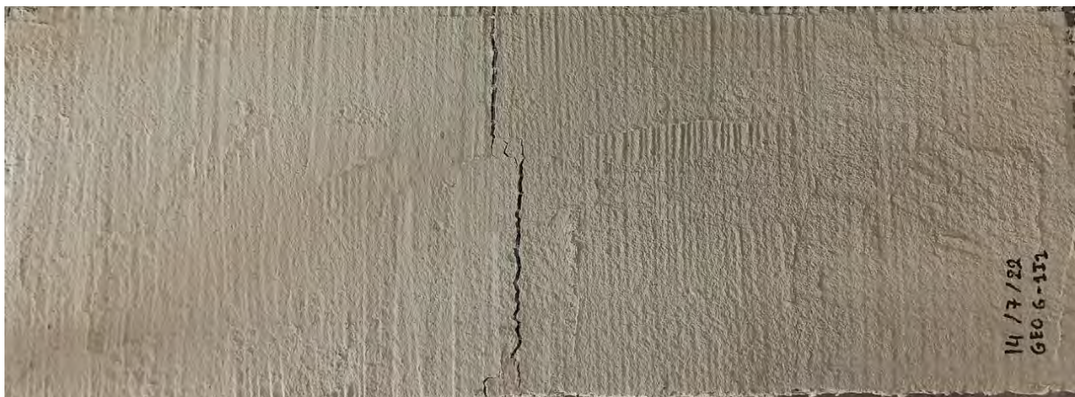
Σχήμα 4.19: Εικόνα αστοχίας του δοκιμίου "OOP_WALL_GEO-G-111".
