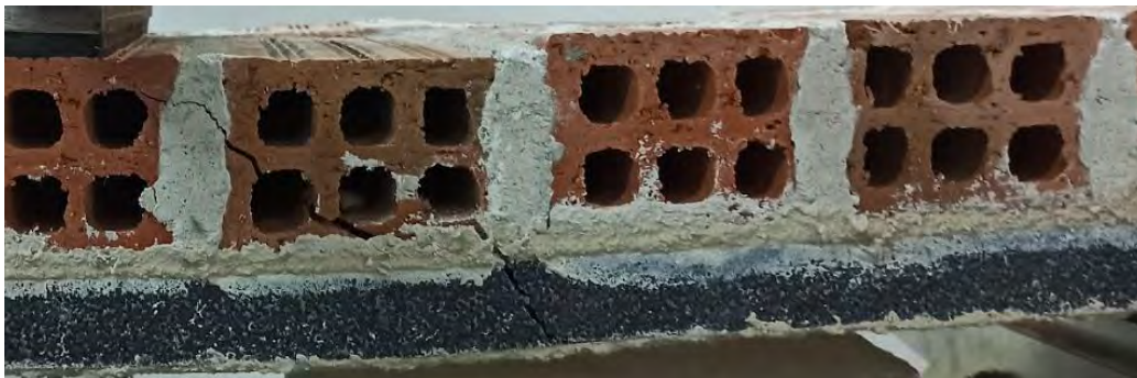
Σχήμα 4.17: Εικόνα αστοχίας του δοκιμίου "OOP_WALL_GEO-B-111".
