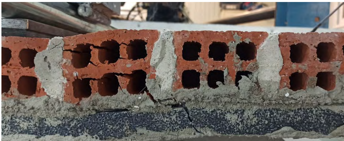
Σχήμα 4.20: Εικόνα αστοχίας του δοκιμίου "OOP_WALL_CEM-B-111".
