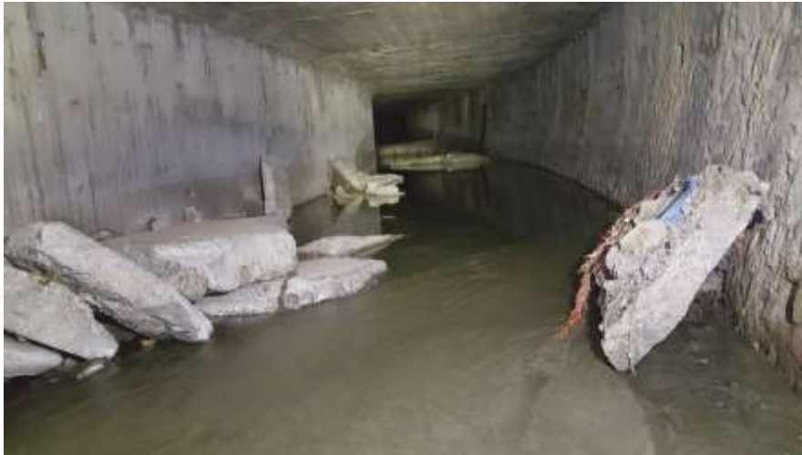
Εικόνα 3: Υπόγεια κοίτη Ιλισού Πηγή Urban Speleo Engineering / Αρχείο Παναγιώτη Δευτεραιού
