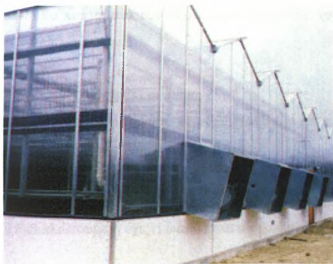
Εικόνα 2. Σύστημα δυναμικού αερισμού.
