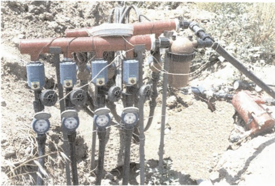
Φωτογραφία 3. Η μονάδα ελέγχου όπως ήταν τοποθετημένη στο πειραματικό αγρό στο Βελεστίνο όπου φαίνονται ο προγραμματιστής, οι ηλεκτροβάνες με τους υδρομετρητές και το φίλτρο σίτας.
