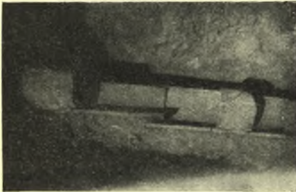
Εἰκ. 6. Τμήμα ὑδροσωλήνος.
