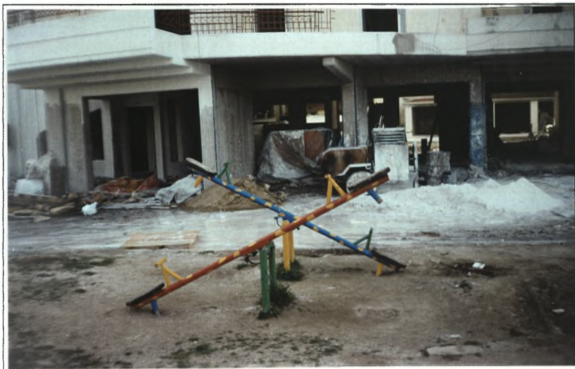
Φωτο 3: Ύπαρξη οικοδομικών υλικών δίπλα στον χώρο της παιδικής χαράς.
