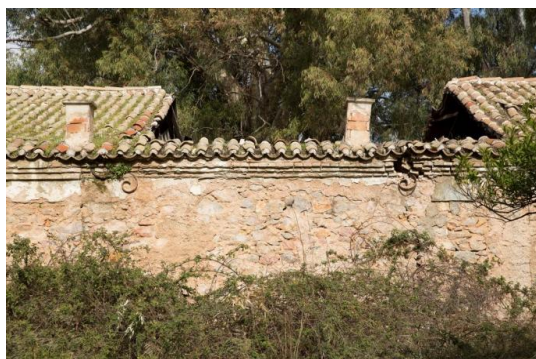
Εικόνα 35: Κατάρρευση στέγης Κτιρίου 6
