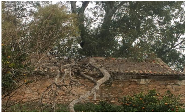
Εικόνα 48: Κατάρρευση στέγης Κτιρίου 6
