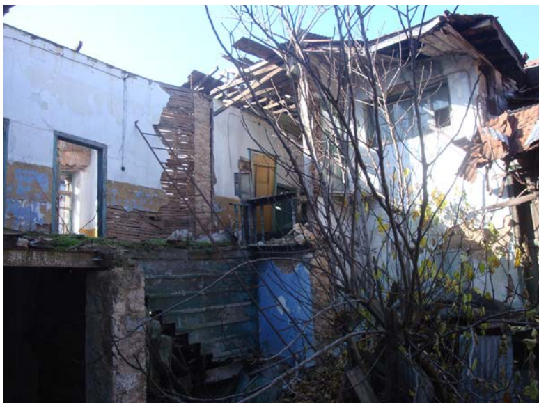
Εικ. 59 Κατάσταση κτηρίων Χάνι Μανέκα, καταγραφή Υπηρεσία Νεωτέρων Μνημείων και Τεχνικών Έργων Ηπείρου, 2011
