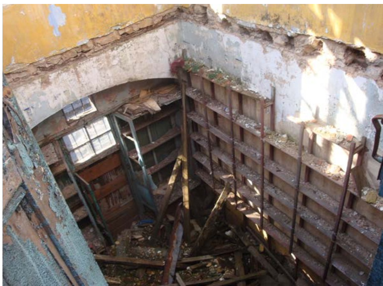
Εικ. 61 Κατάσταση κτηρίων Χάνι Μανέκα, καταγραφή Υπηρεσία Νεωτέρων Μνημείων και Τεχνικών Έργων Ηπείρου, 2011
