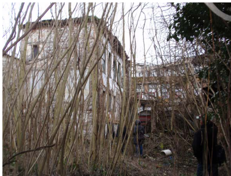
Εικ. 7 Κατάσταση κτηρίων Χάνι Μανέκα, καταγραφή Υπηρεσία Νεωτέρων Μνημείων και Τεχνικών Έργων Ηπείρου, 2017
