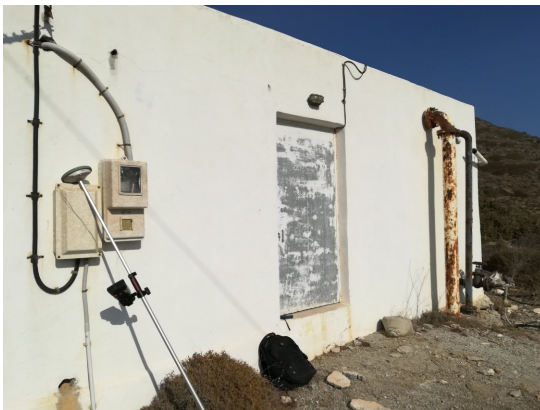
Εικόνα 18 Αντλιοστάσιο-Βοηθητική Δεξαμενή στην περιοχή της Καστελόπετρας(Φωτογραφία Κρόσμαν-Νασιόπουλος Φρειδερίκος)
