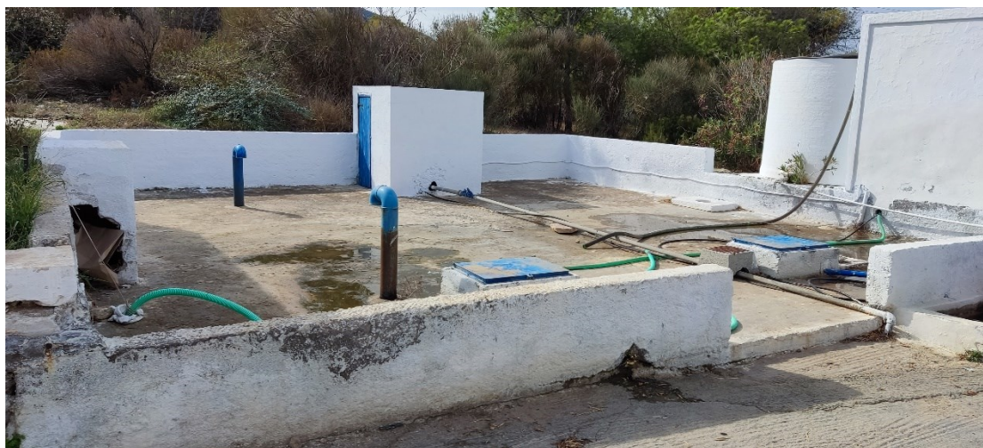
Εικόνα 22 Αντλιοστάσιο-Βοηθητική δεξαμενή Κολοφάνας(Φωτογραφία Γαβαλάς Μηνάς)
