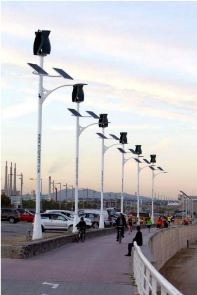
Εικόνα 4: Σύστημα δημόσιου φωτισμού Llevant Beach Barcelona
