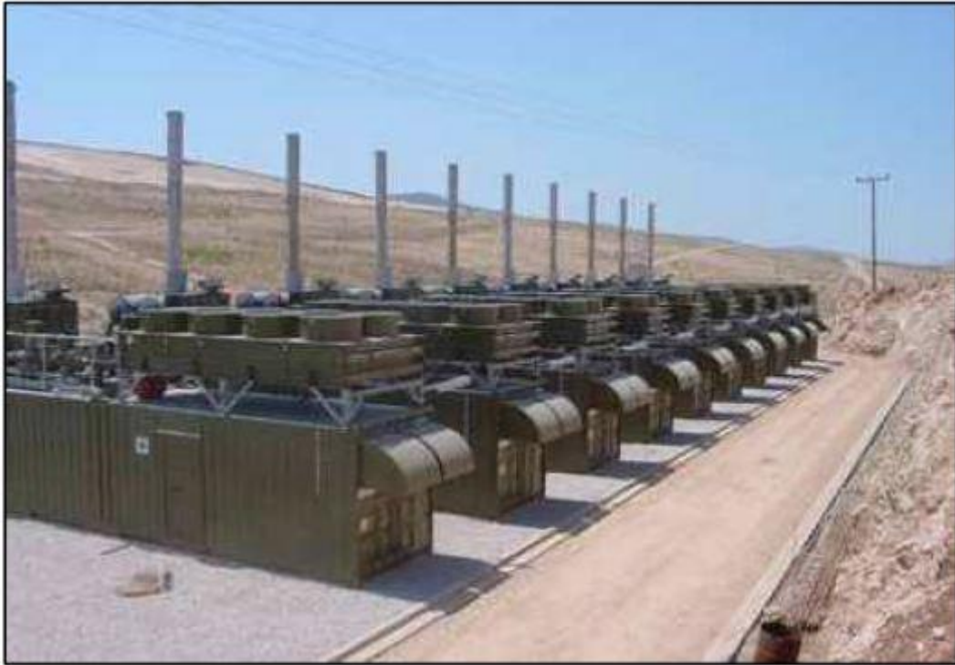
Εικόνα 18: Μηχανές εσωτερικής καύσης στον ΧΥΤΑ Άνω Λιοσίων ( www.helector.gr )
