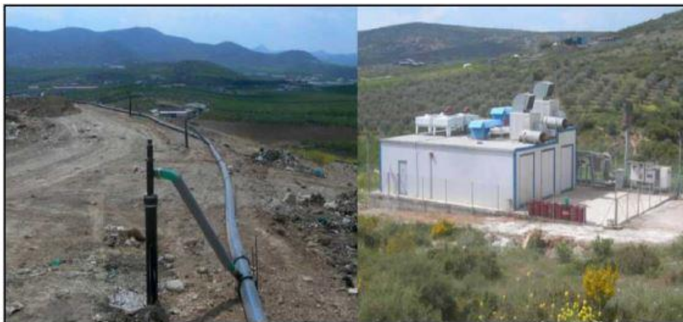
Εικόνα 19: Αριστερά: Δίκτυο συλλογής και μεταφοράς του βιοαερίου, Δεξιά: Μονάδα ΣΗΘ στον ΧΥΤΑ Βόλου ( www.vioenergeia.gr/gallery , 2010)
