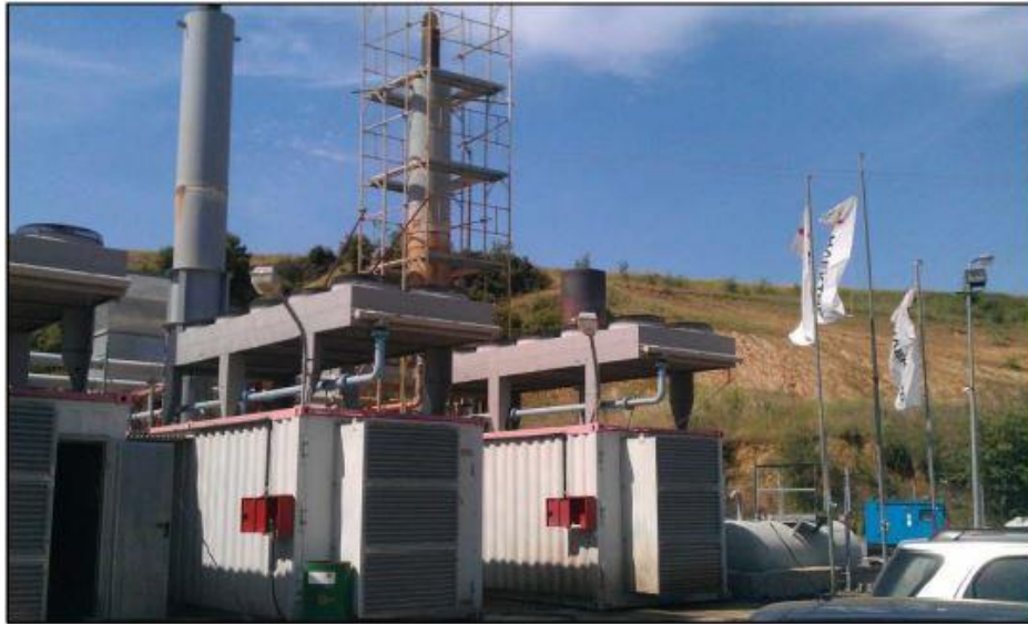
Εικόνα 21: Εγκατάσταση ΣΗΘ στην περιοχή του ΧΥΤΑ Ταγαράδων
